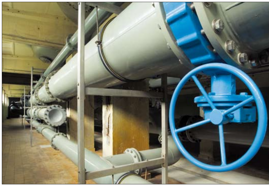
Rohrleitungen unter der Filterreihe – von hier geht das Trinkwasser zu den Verbrauchern.
