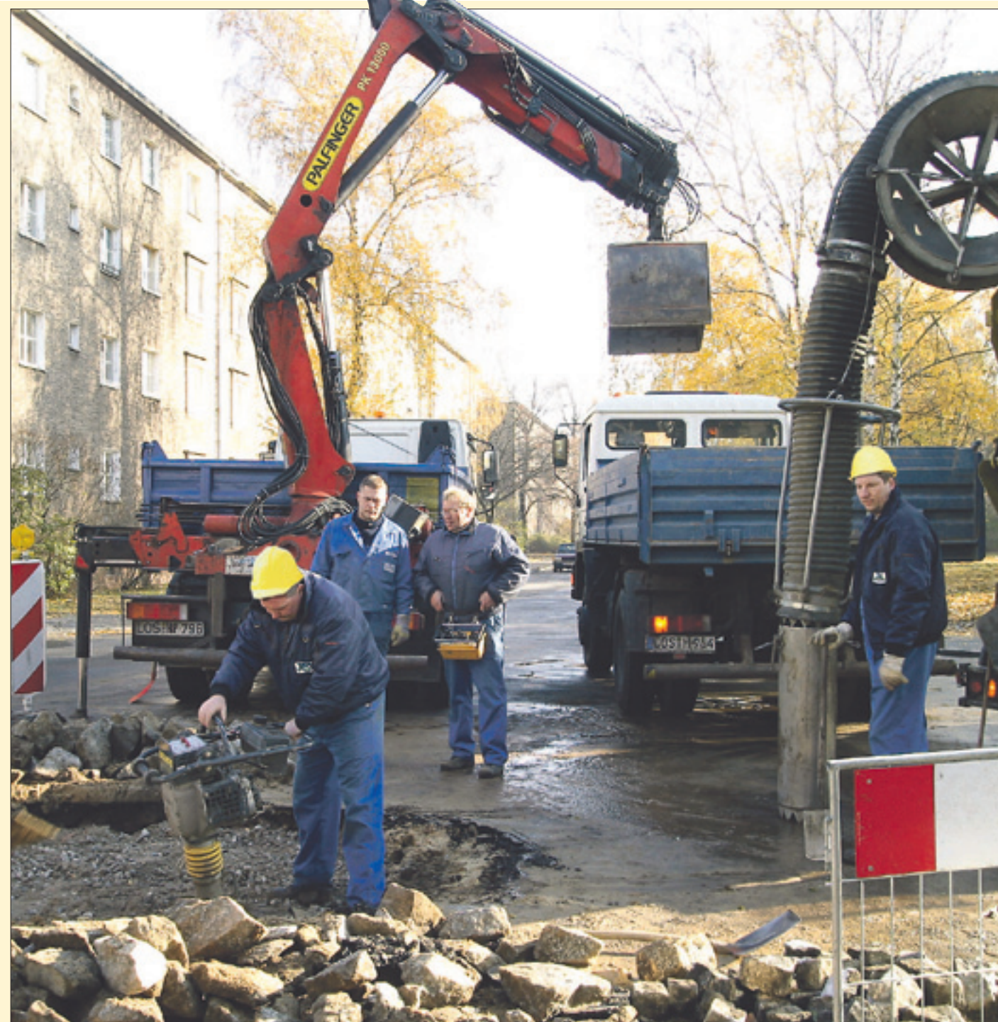
So sieht es aus, das Zusammenspiel bewusst aufgebauter und gut harmonisierender Einsatzkräfte bei einem Rohrbruch.
