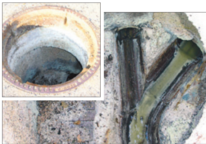
Starke Schwefelkorrosion an Schachtbauwerken.
