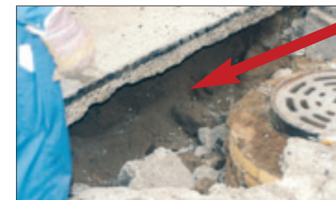
Solche von Ratten verursachten Ausböhlungen bleiben oft lange unentdeckt; die Schadensbeseitigung ist teuer.
