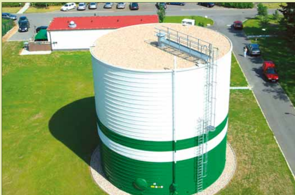
Sichtbares Zeichen wachsenden Anlagevermögens: Faulgaspeicher der Kläranlage.
