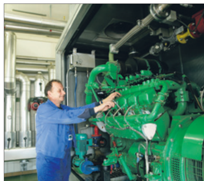
Schrauben an der „Geldmaschine“, am Gasmotor im BHKW.
