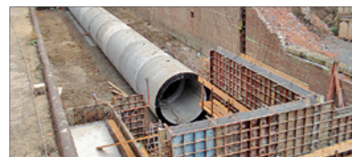
Bis zum Jahresende wird am neuen Sandfang gebaut. Rechts ist die Mauer der alten Oberschleuse zu sehen.
