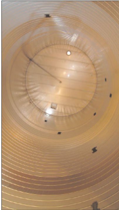
Technik mit eigenem Kunstwert! So schön und glänzend präsentierte sich das Innere des Hydrolysereaktors nur in den Tagen seiner Montage auf der Abwasserbehandlungsanlage. Inzwischen wird das beschichtete Metall seiner Funktion als säurebeständiger „Arbeitsraum für Mikroorganismen“ gerecht.
