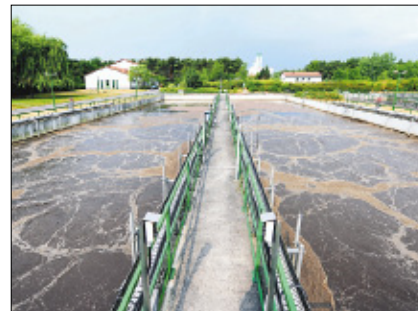
Eines der Belebungsbecken der Kläranlage Eisenhüttenstadt.
