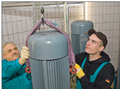
Martin Kuchel (links) und Lehrling Marcel Ujfalusi beim Pumpenwechsel im Hauptpumpwerk Buchwaldstraße (Fürstenberg).
