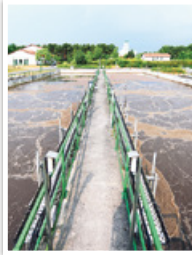
Mit dem Umbau zu einer „energieeffizienten“ Kläranlage will der TAZV den Energieverbrauch um 60% reduzieren.
