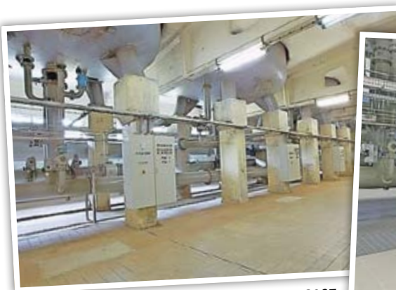
Diese Aufnahme stammt aus dem Jahr 2007 und zeigt den Blick in die Filterhalle.
