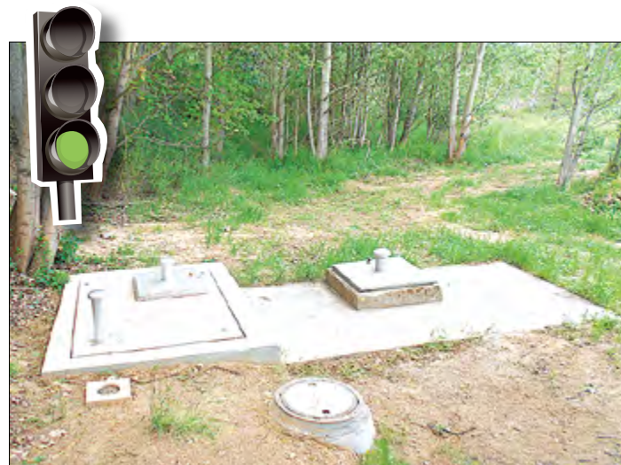
Mehrere Tausende Euro später: Als wäre nichts gewesen – die Anlage nach der Schadensbeseitigung.
