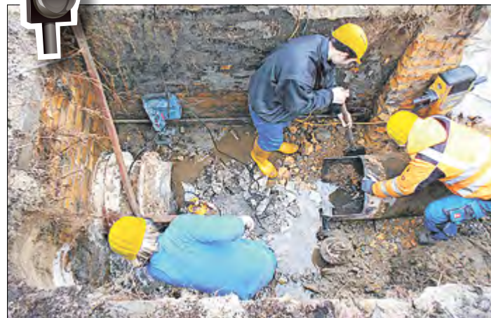
Das Bild entstand kurz nachdem das schadhafte Rohrstück rausgeschnitten wurde.
