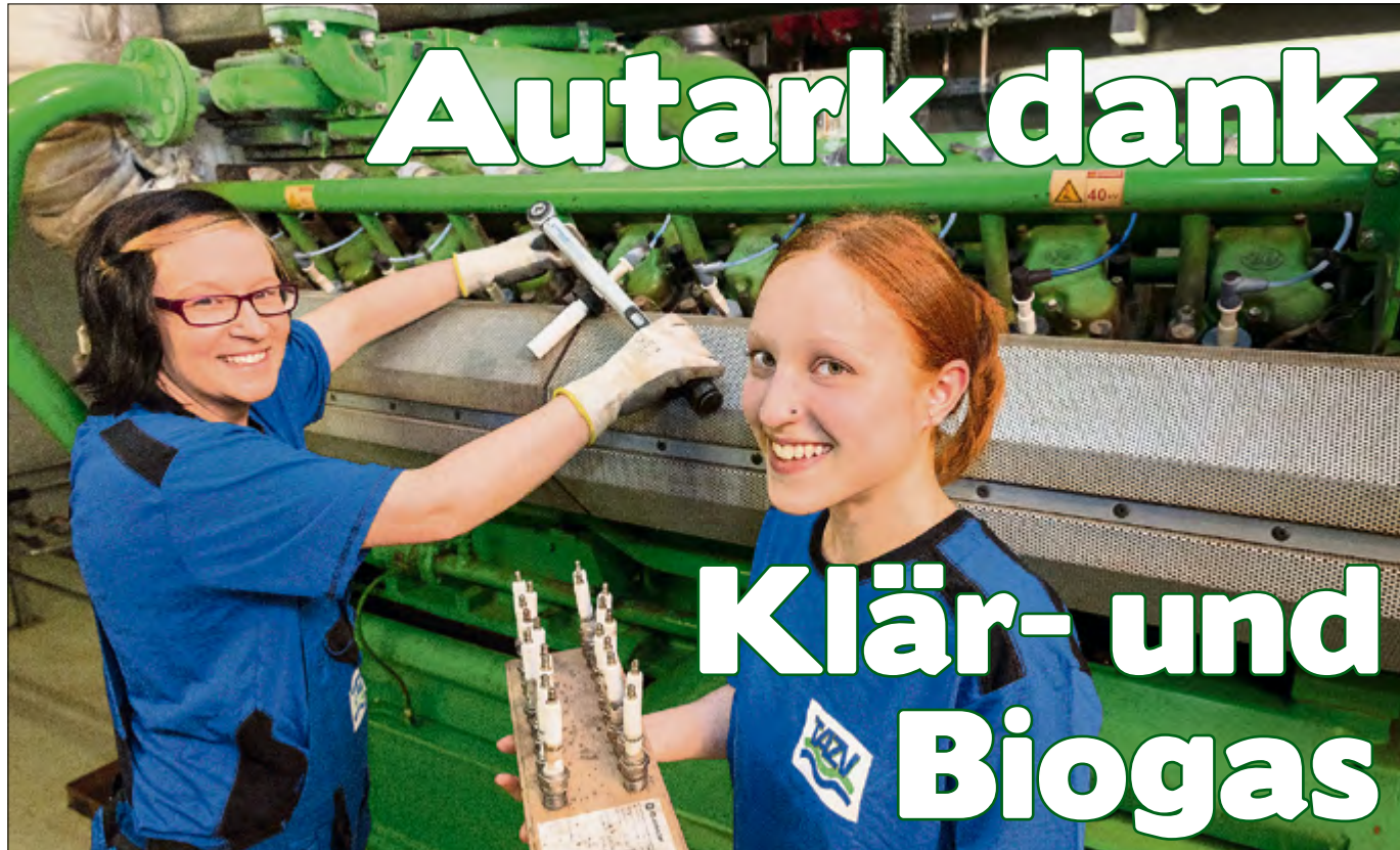
Frauen-Power am 20-Zylinder-V-Motor: Die TAZV-Mitarbeiterinnen Corinna Gesch (l.) und Linda Kretzschmar wechseln die Zündkerzen. Die beiden arbeiten am BHKW der Abwasserbehandlungsanlage im Industriegebiet, das maßgeblich zur positiven Energiebilanz des Verbandes beiträgt.
