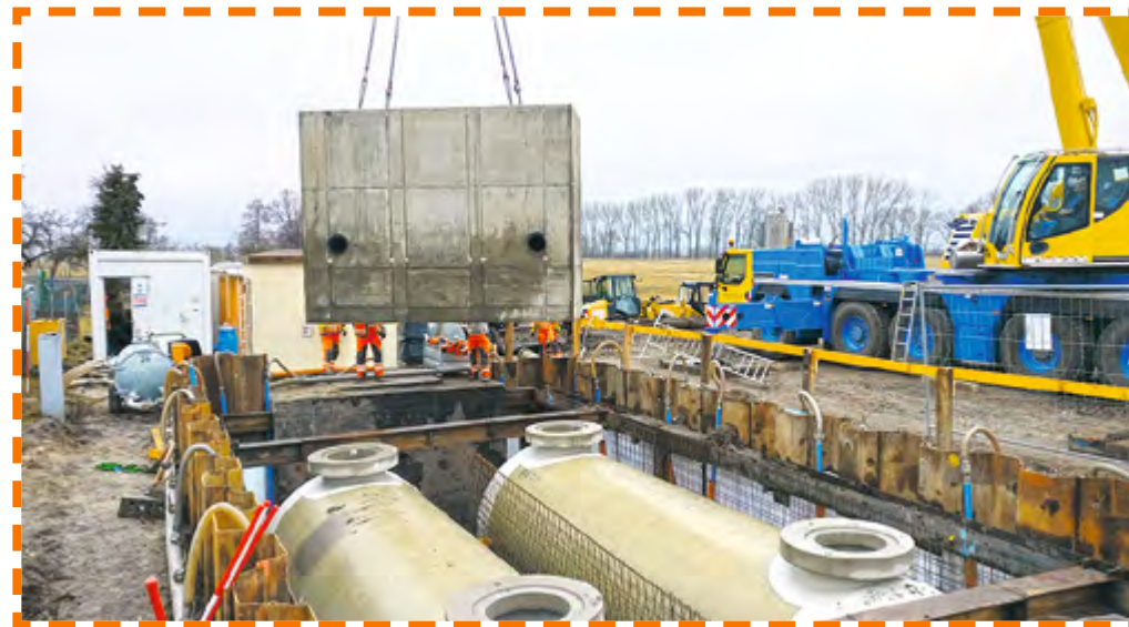
Um das Pumpwerk vor Auftrieb zu schützen, wurde ein 31 t schwerer Pumpenvorschacht montiert. Die neuen Speicherbehälter nehmen das Wasser bei Starkregen auf.
